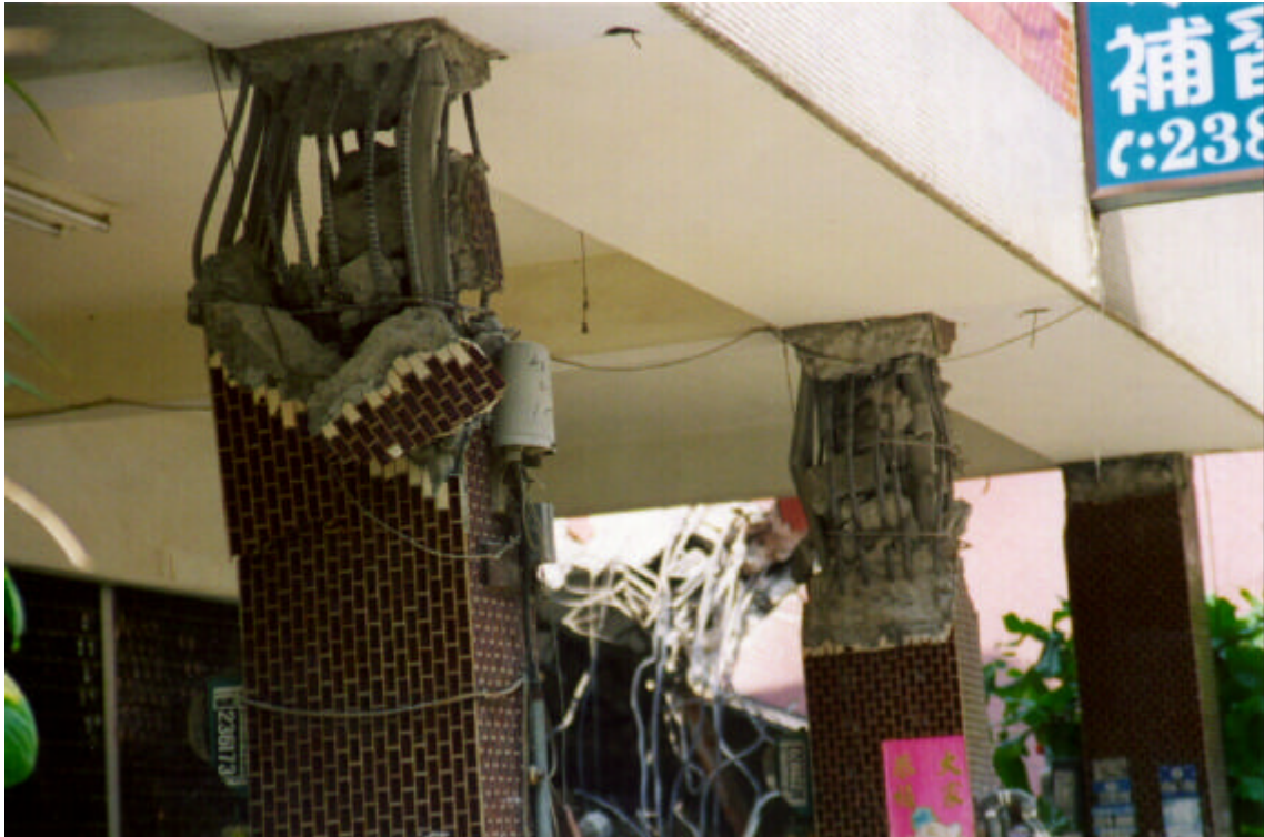
圖 4.5 因埋置大量管線且主鋼筋錯位都會造成強度減弱 混凝土破裂剝離
