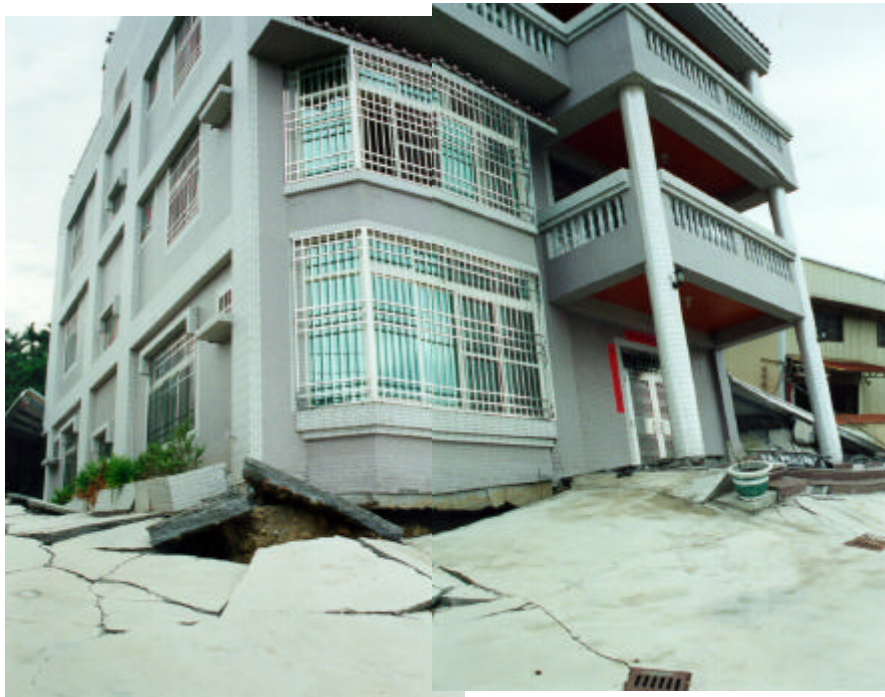
圖 4.1 台中縣一江橋旁的民宅，因位於斷層附近，雖已嚴重傾斜但上部結構與基礎仍無明顯損害
