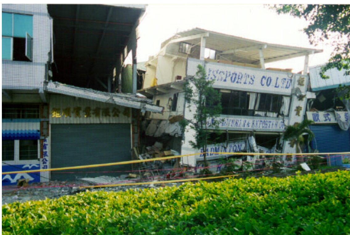
圖 4.3 因鄰屋碰撞而倒塌的實例
