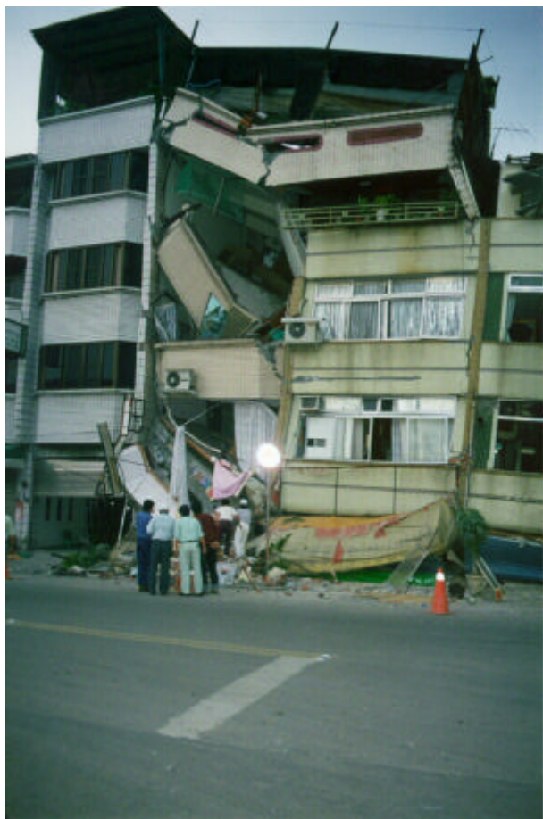
圖 4.2 不同時期興建，但互相搭接且共用一面磚牆的加強磚造型式建築物，在地震時，不具韌性的樑柱系統無法承受額外的荷重倒塌，鄰房也因此受到牽連。
